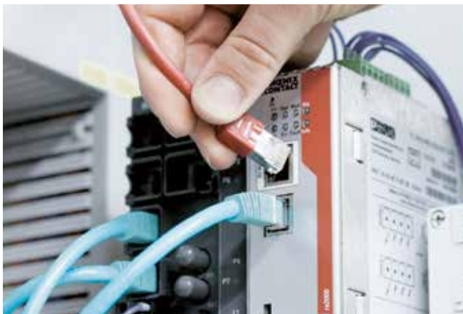
Maximale Sicherheit wird durch den Einsatz moderner Fernwartungslösungen gewährleistet.
